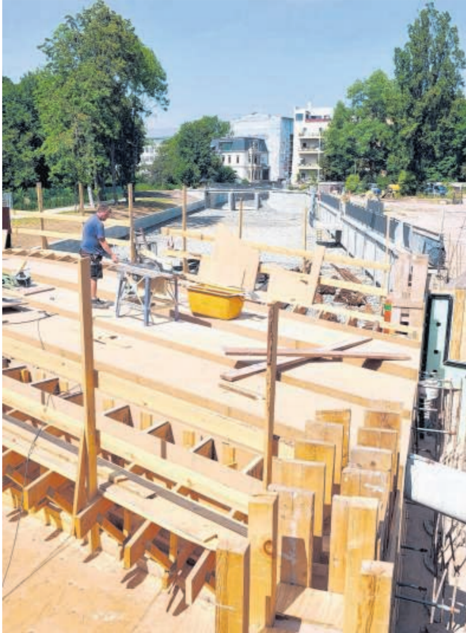
Der Ausbau des Elstermühlgrabens zwischen Schreiber- und Friedrich-Ebertstraße ist fast abgeschlossen. Rechts davon entsteht der Stadthafen. Foto: Wolfgang Zeyen
